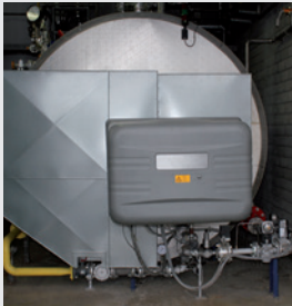
Zweigasbrenner mit O 2 /CO-Regelung an Dampfkessel mit Durchsatz von 5 t/h Two-gas burner with O 2 /CO control at boiler with a flow rate of 5 t/h
