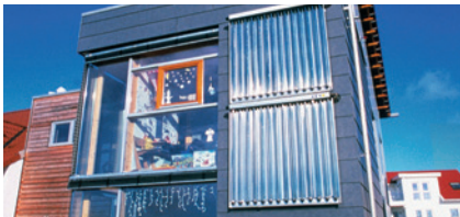
Praxisbeispiel für die Anwendung von Solarthermie-Vakuümrohrenkollektoren Example of vacuum tube collector installations
